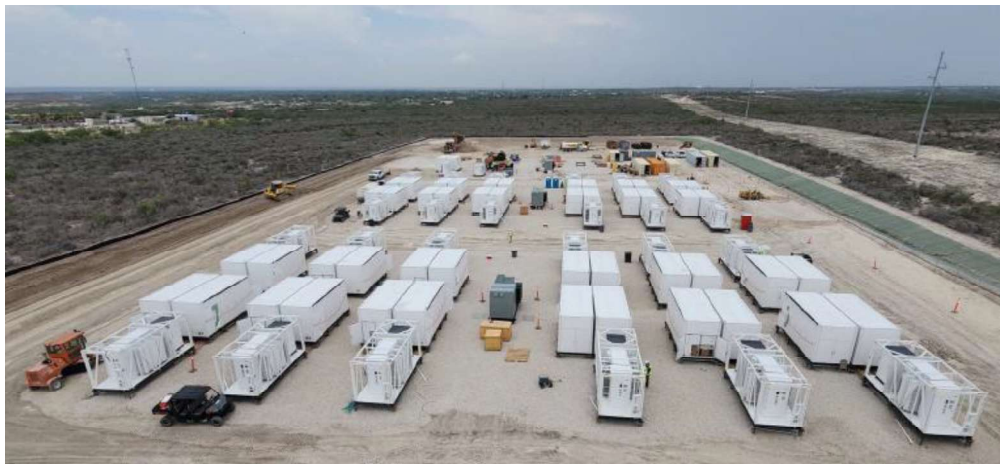
[蓄電池設備 写真]
